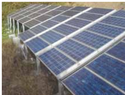
Páneles solares que captan la energía solar.
